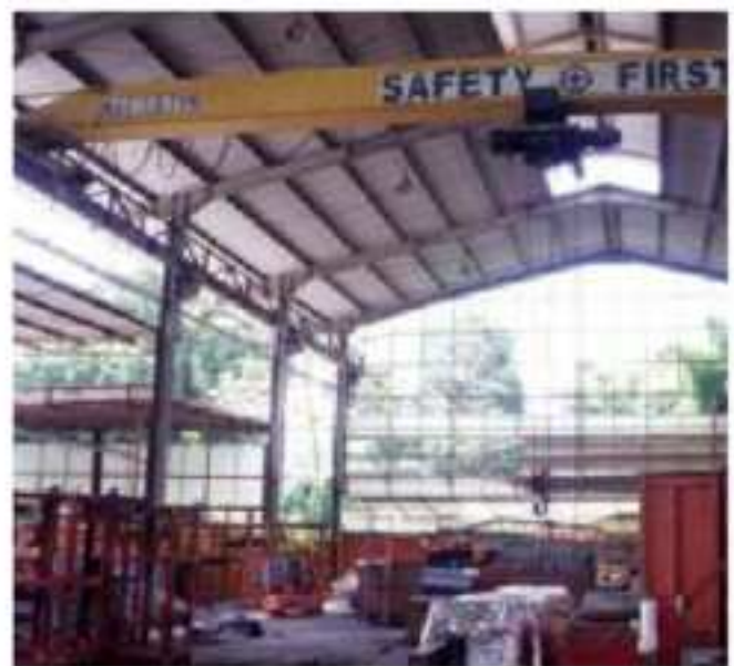
Overhead Crane 7,5 Ton
